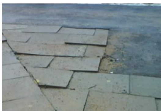
Uneven flagged Footway
